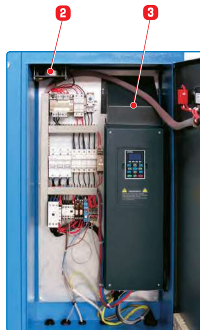
Quadro elettrico e inverter.
