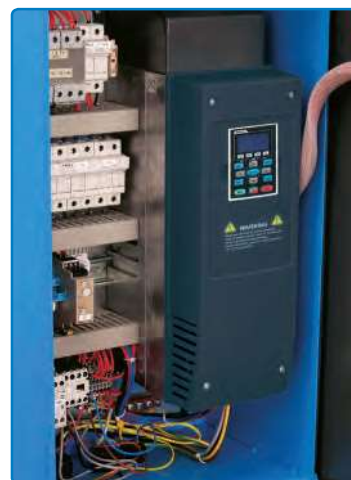
Quadro elettrico e inverter.
