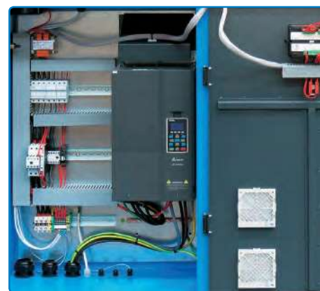
Quadro elettrico e inverter.
